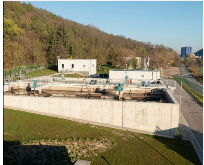
Abbildung 13: TIA Portal – Optimiertes Engineering in Abwasseranlagen – Ausrüstung eines Klärwerks im bulgarischen Provadia durch Biogest International GmbH
