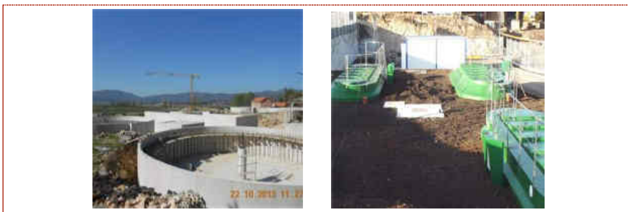
Abbildung 5.25: Kläranlage Nikšić (links) und Kläranlage Žabljak (rechts)
