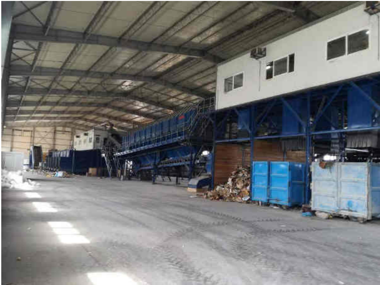
Abbildung 4.16: Sortieranlage für Siedlungsabfälle, Podgorica, Juli 2017
